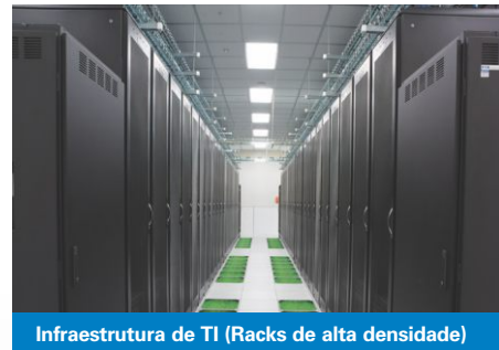
Infraestrutura de TI (Racks de alta densidade)
